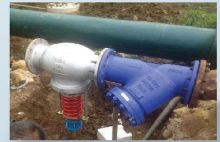
華東助劑蒸汽工程
