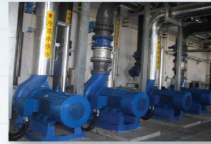
正崴集團冰水機房工程
