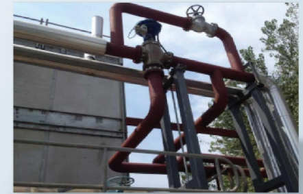
愛克發印板蒸汽工程
