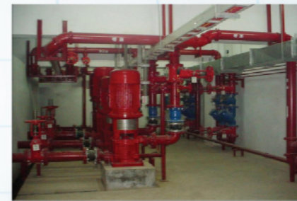
臻鼎科技消防工程
