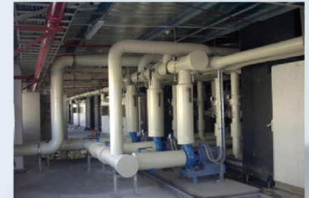
昆穎電子空調工程
